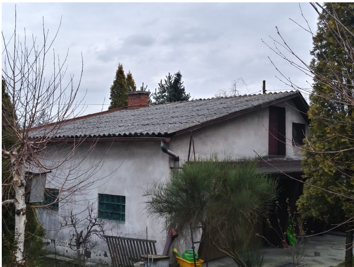
Rysunek 5 Dach pokryty płytami azbestowymi falistymi na terenie Pszowa
