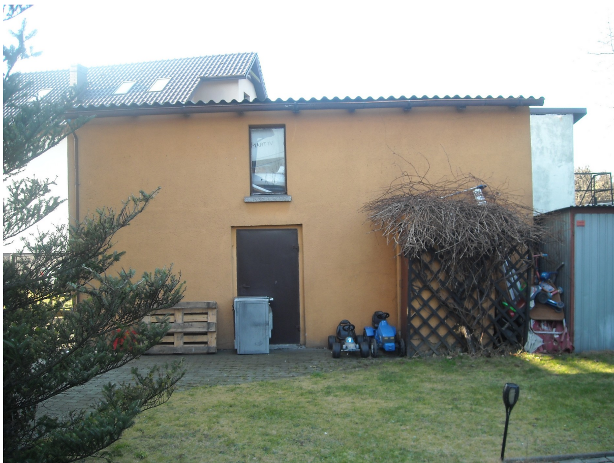
Rysunek 10 Dach budynku gospodarczego pokryty płytami azbestowymi falistymi na terenie Pszowa
