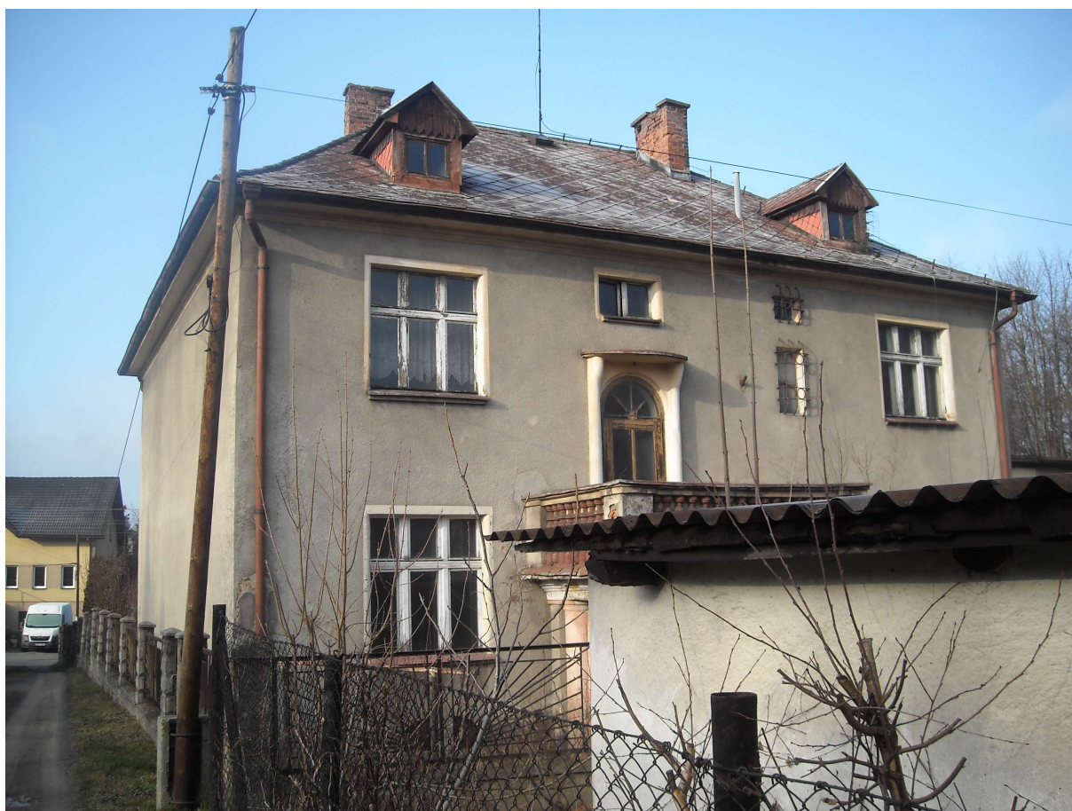
Rysunek 6 Dach pokryty płytami azbestowymi płaskimi na terenie Pszowa
