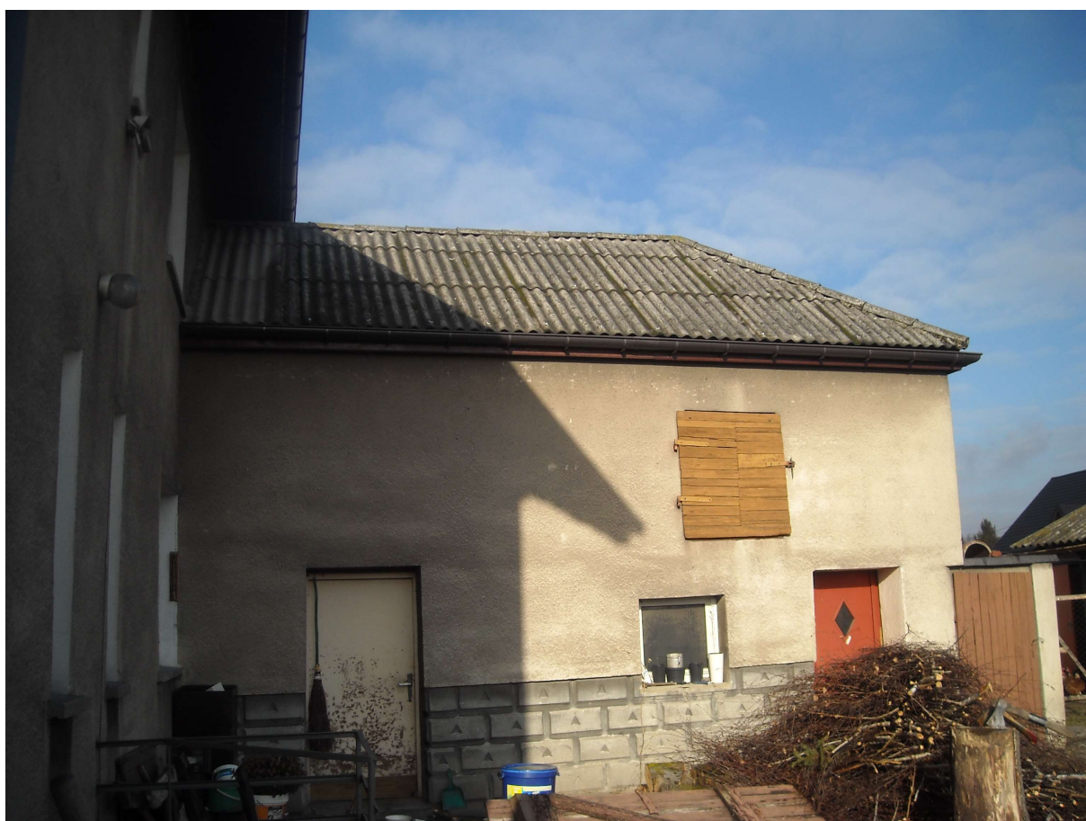
Rysunek 12 Dach budynku gospodarczego pokryty płytami azbestowymi falistymi na terenie Pszowa
